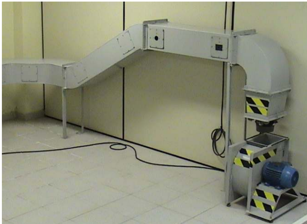
Figura 2.3 – Entrada do duto com o motor que gera o ruído.
